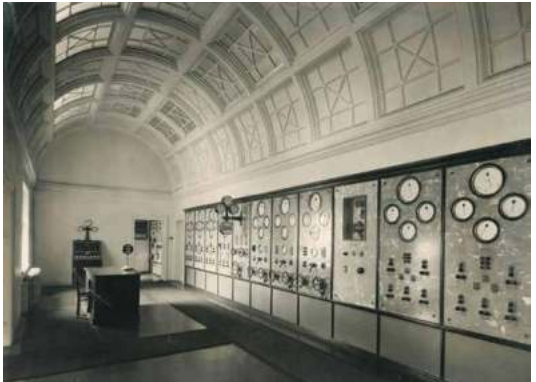
Schaltraum der Dieselzentrale des Elektrizitätsverbandes Gröba © Stadtmuseum Riesa
