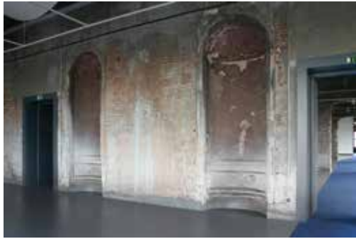
Residenzschloss Dresden, Eckparadesaal, Südwand mit Ofennischen, Zustand 61 Jahre nach der Zerstörung, 2006
