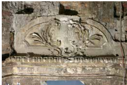
Residenzschloss Dresden, Eckparadesaal, Stuckdecke im Eckturm, Stucklunette, Zustand 61 Jahre nach der Zerstörung, 2006
