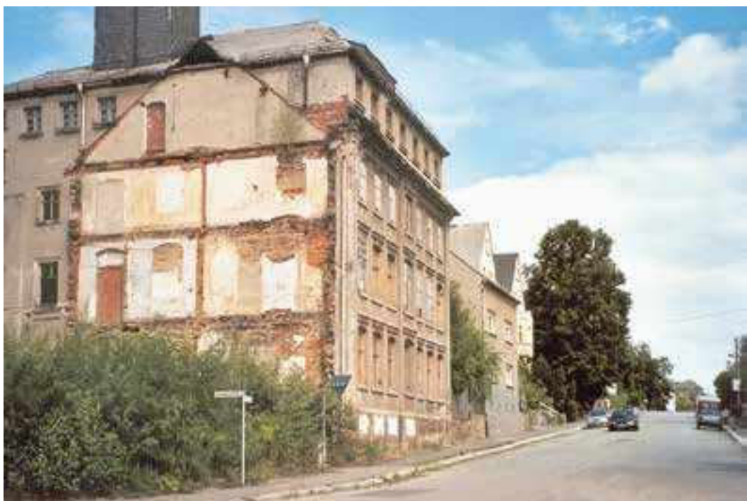
Noch immer sind in Oberfrohna zahlreiche Brachen zu sehen. Hier der leerstehende Fabrikstandort der Firma Schulze & Grobe, 2005 Foto: Hermann Schnurrbusch
